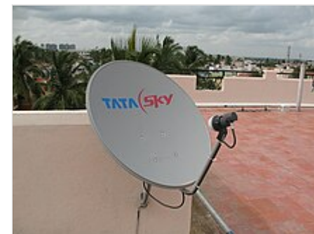
Спутниковая антенна на крыше дома
