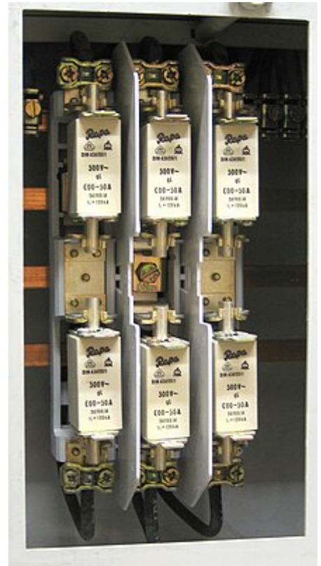
Ножевые предохранители, представляющие потенциальную опасность электротравм при замене
