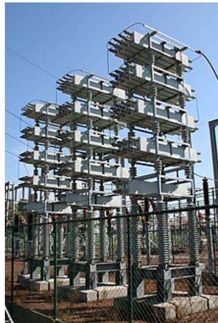
Батарея конденсаторов 150 кВ 75 МВ·А на электрической подстанции
