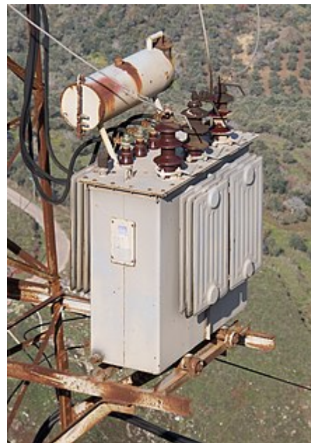
Мачтовая трансформаторная подстанция с трёхфазным понижающим трансформатором
