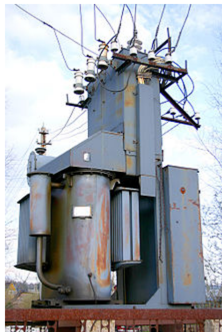
Трёхфазный понижающий трансформатор мачтового типа, 10-6/0,4кв. Распространён в сельской местности
